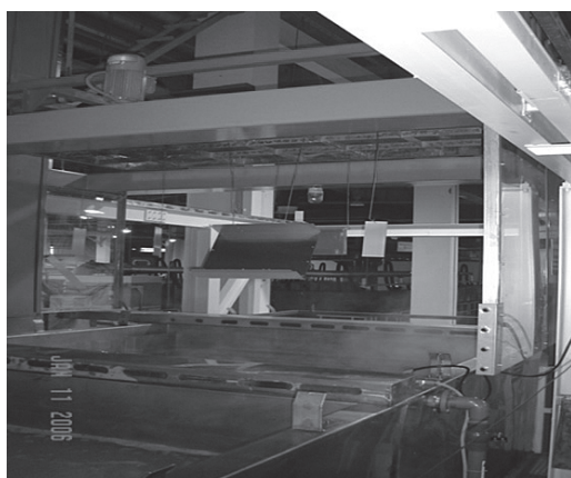
写真－１ 大型コンピュータールームとCPUエンクロージャーキャビネット
